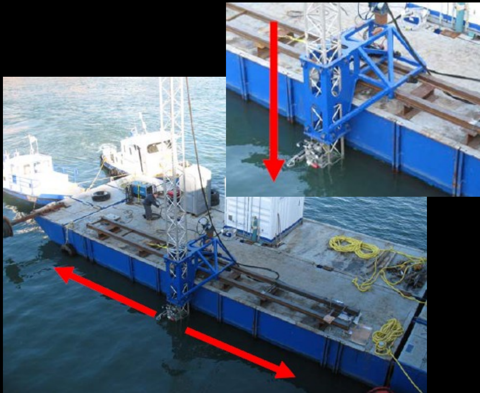
Déploiement à partir d'une barge mécanique au Port de Montréal (Photo: Groupe Océan)
