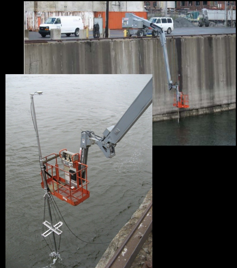
Déploiement à partir d'une grue télescopique au Port de Montréal (Photo: Port de Montréal)
